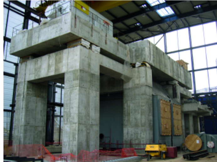
Abb. 4: Dampfturbinenfundament, KW Thessaloniki/Griechenland
