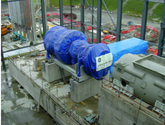
Abb. 3: Gasturbinenfundament mit Gasturbine (rechts) und Generator (links), KW Coolkeeragh in Londonderry/Nordirland Fotos: © Uzunoglu
