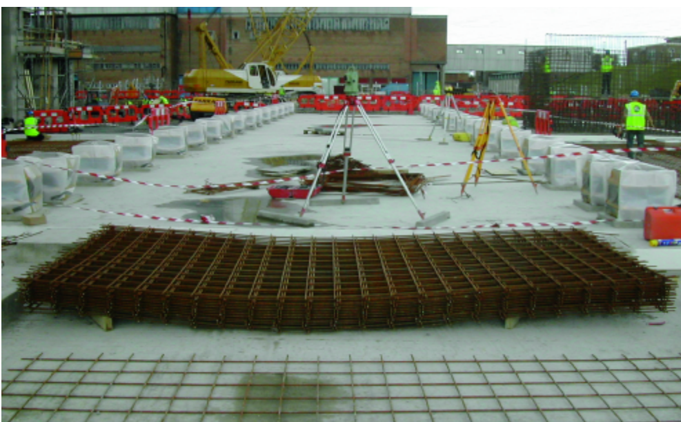
Abb. 2: Federelemente zur Lagerung des Gasturbinenfundaments, KW Coolkeeragh in Londonderry/Nordirland Foto: © Uzunoglu
