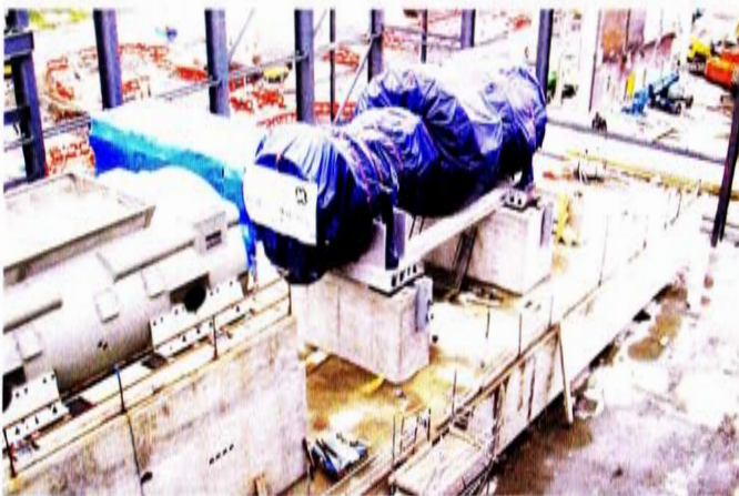
Bild 11. Gasturbinenfundament mit Gasturbine (rechts) und Generator (links) Fig. 11. Gas turbine foundation with gas turbine (right) and generator (left)
